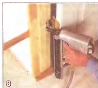
8 Крепление коробки со стороны петель. Прибейте коробку к стойке гвоздями в районе петель. Гвозди обязательно должны пройти через прокладки
