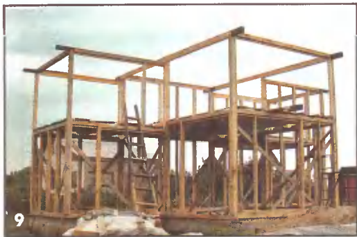
9 Каркас вырос до разновысокой верхней обвязки. Фронтонные выпуски окрашены еще на земле
