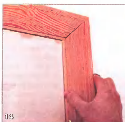
Неравномерный зазор. Если коробка и стена немного расходятся, наличник выглядит неаккуратно
