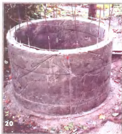
Первая заливка. Пескобетон был уплотнен очень тщательно — на поверхности кольца нет ни одной раковины
